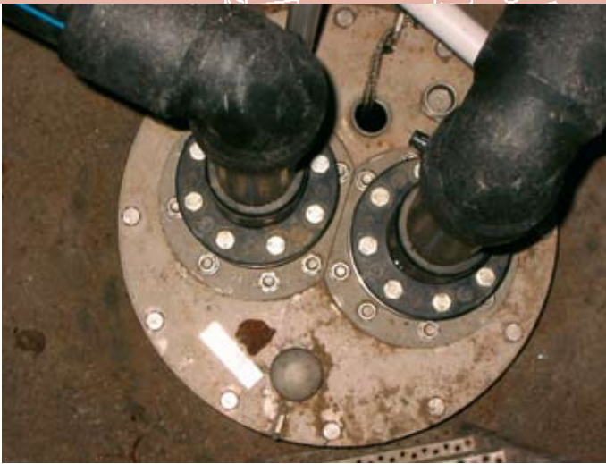
■ Das Bild zeigt den Brunnenkopf des 30 m tiefen Brunnens. Er verfügt über zwei Steigleitungen (DN 100), die jeweils bis zu 45 m 3 /h Grundwasser zu einem Plattenwärmetauscher leiten.
