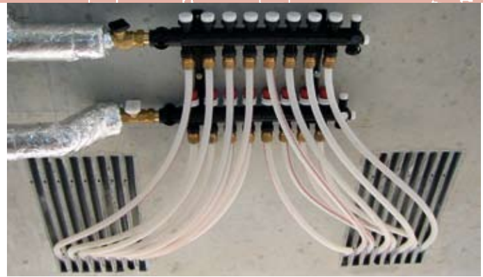
■ Verteiler/Sammler für die Betonkernaktivierung „Contec“. Das System deckt sowohl die Heiz- als auch die Kühlgrundlasten in den Büroräumen ab.
